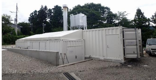
田園プラザホテル（川場村） LCS 260kW チップ
